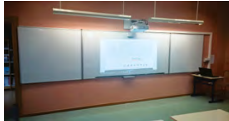
Le nouveau VPI installé en septembre 2016 dans la classe de CE2/CM1
